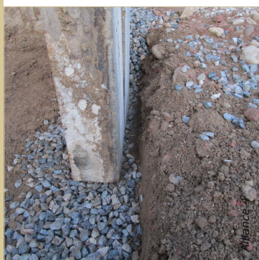
Une bonne couche de gravier de part et d'autre du bois sert de drain.
