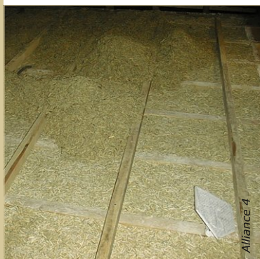
Le chanvre stabilisé est mis en place en deux couches de 15 cm rabattues par tassage à 10 cm. L'épaisseur conseillée de la régulation est de 20 cm.
