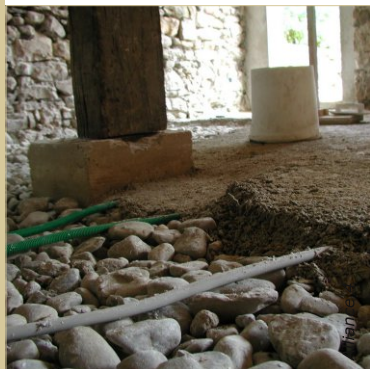
Les gaines du réseau sanitaire sont positionnées au milieu de la dalle isolante. Le hérisson est totalement adapté à recevoir une dalle isolante en béton de chanvre.
