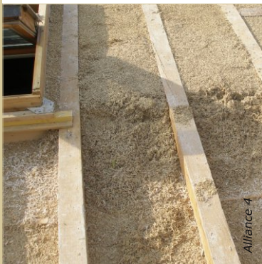
La régulation est mise en place en deux passes pour assurer une bonne structuration des premières épaisseurs..
