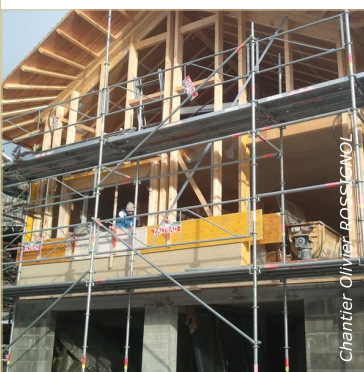
Dans ce chantier, le béton de chanvre est mis en place sur la partie haute, le rez-de-chaussée n'est pas isolé.
