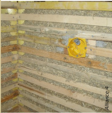
Les réseaux techniques sont noyés dans le remplissage végétal. Il convient d'isoler les appareillages électriques avec du mortier.
