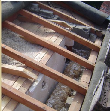
Pour accéder aux arases de mur, la couverture a été retirée sur une bande, tout le long du mur.
